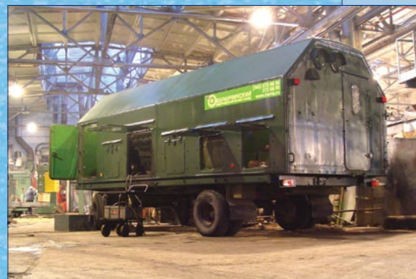
ДИЗЕЛЬНАЯ ЭЛЕКТРОСТАНЦИЯ МОЩНОСТЬЮ 200 КВТ В КУНГЕ
